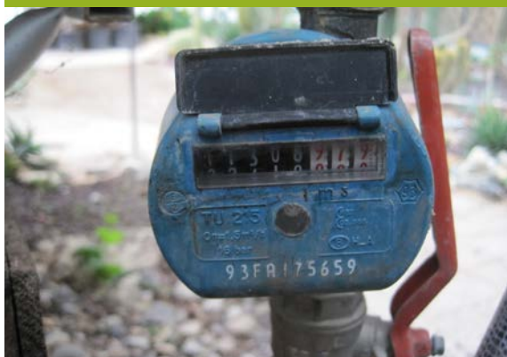
Un compteur de la ville de Mérignac (source : Mérignac)
