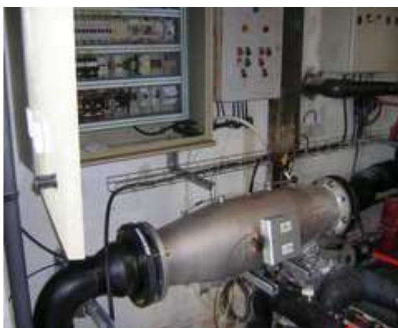
Piscine et déchloration
