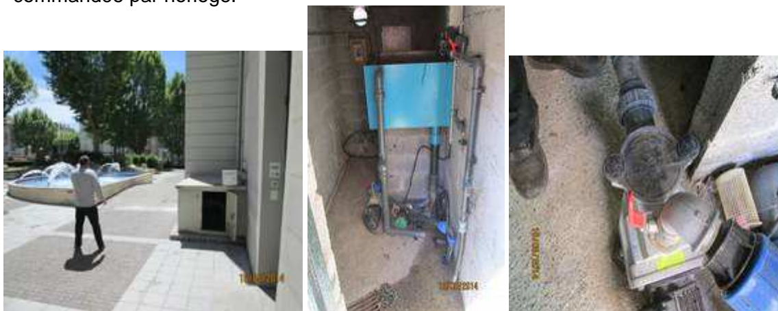
Détails : locaux techniques installés près de la fontaine, dont le 2ème incluant un réservoir tampon, pompe avec filtre (ville de Digne les Bains)
