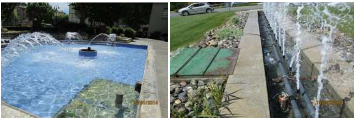
Fontaines en circuit fermé à Digne les Bains
