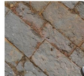
Dalles en pierres calcaires à joints non poreux et dégradées
