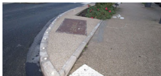
Aucun arbuste n'avait pu se développer à la pointe de ce massif aménagé en bord de voirie. De ce fait, l'espace a été minéralisé en englobant le tampon de la chambre de réseaux. / Pierre Héry
